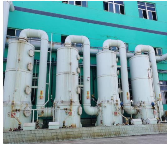
分散染料合成 B 车间二级尿素+二级碱吸收 (车间外西北)
