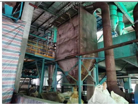
喷塔车间布袋除尘器
