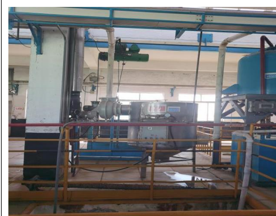
分散蓝 56#合成车间除尘器
