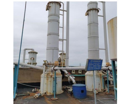
活性炭 21#合成压滤车间二级水吸收
