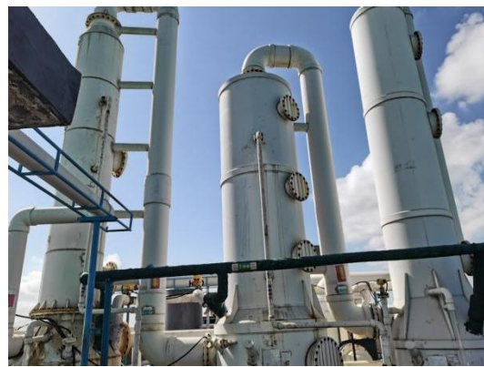
邻氯车间三级碱吸收装置
