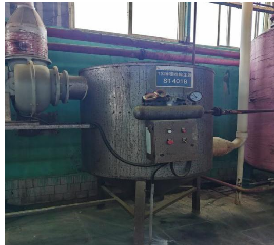
分散染料合成 B 车间除尘器
