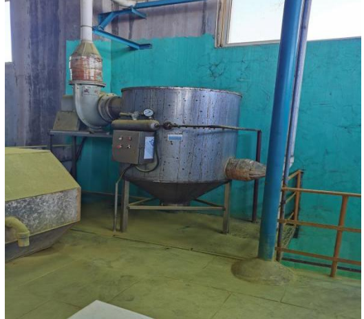
分散染料合成 B 车间除尘器
