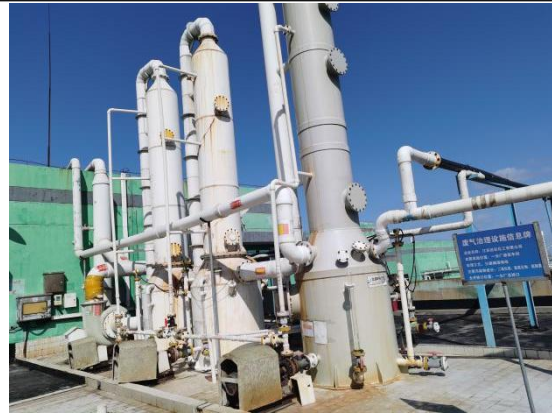
液亚车间三级碱吸收装置
