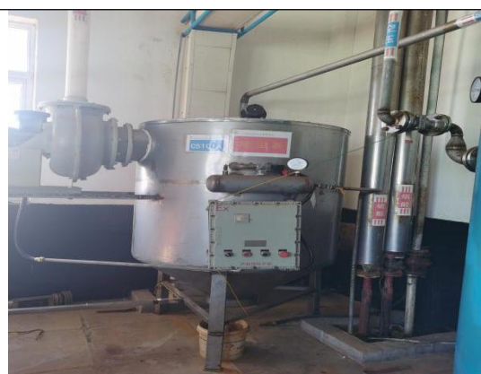
分散蓝 56#合成车间除尘器
