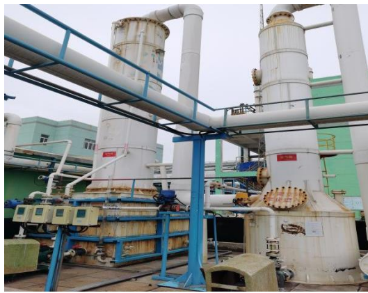
罐区二级水吸收
