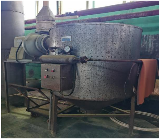
分散染料合成 B 车间除尘器
