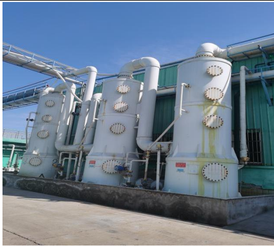
综合压滤车间一级尿素+二级碱
