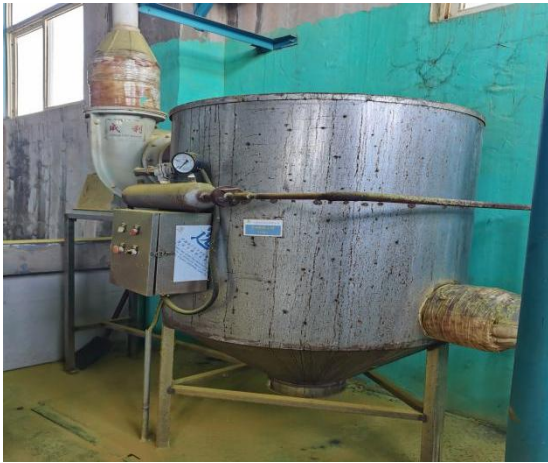
分散染料合成 B 车间除尘器
