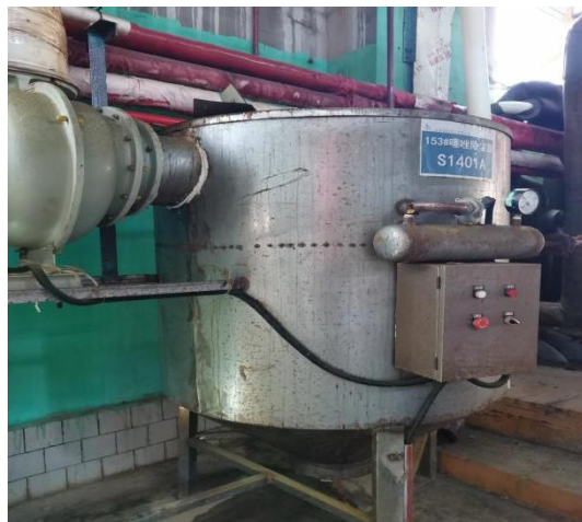
分散染料合成 B 车间除尘器
