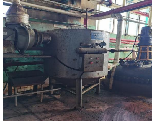
分散染料合成 B 车间除尘器
