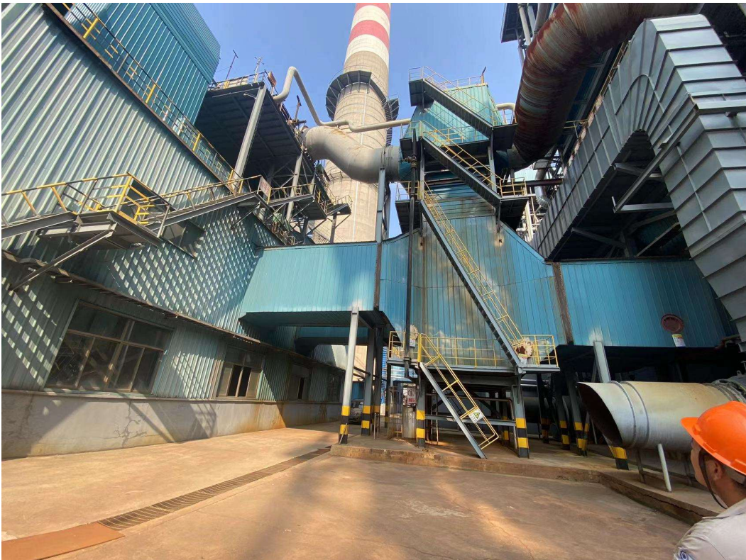
图 3-2 本项目废气处理措施照片图
