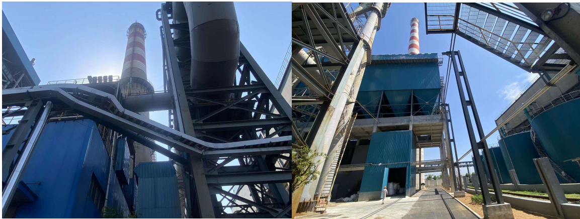
图 3-2 本项目废气处理措施照片图
